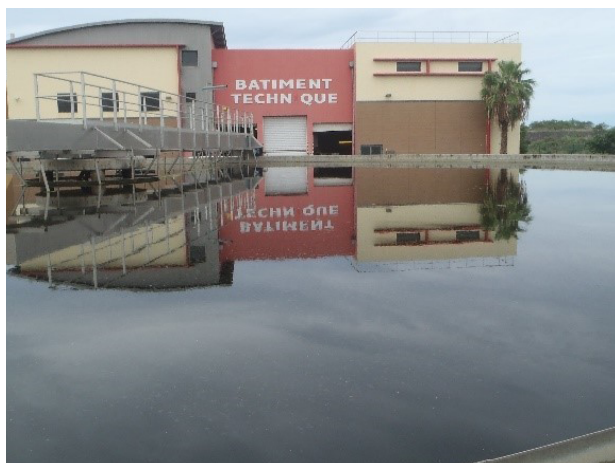
Vue sur le clarificateur de la STEU de Cambaie
